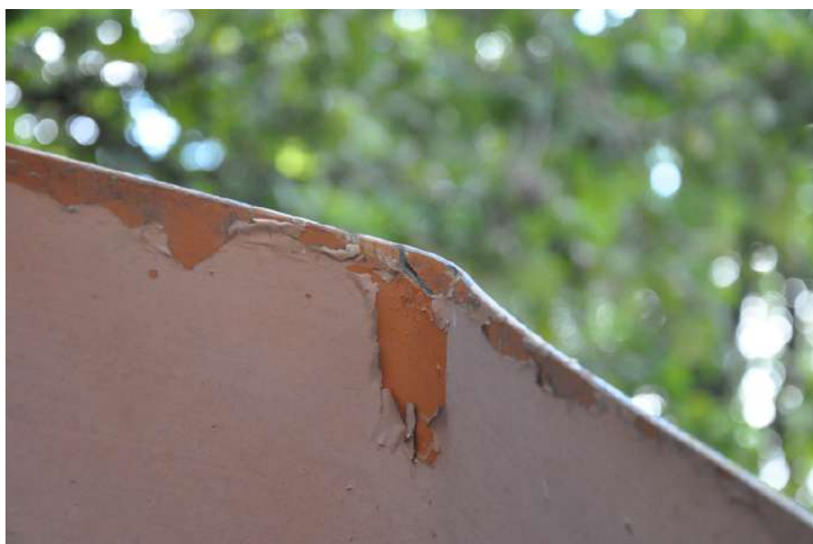
Slika 59. Gornji dio elementa 1 – točka udara (zona označena slovom A na sl. 57) (foto: S. M. Sunara, rujan 2017.)
