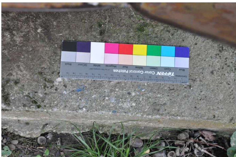
Slika 27. Kapljice plave boje na betonskom postamentu (foto: S. M. Sunara, rujan 2017.)
