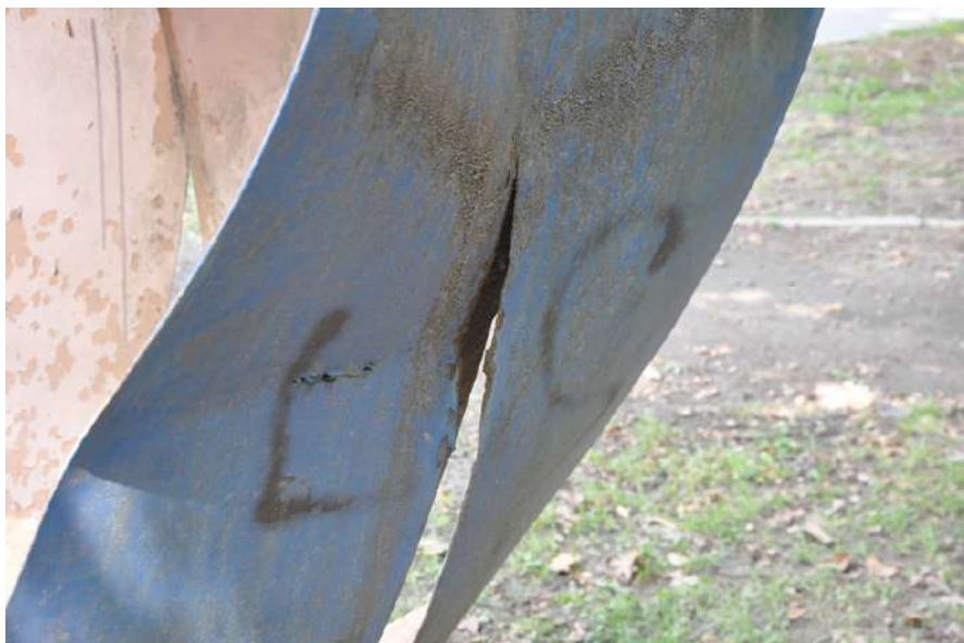
Slika 60. Detalj donje polovice elementa 2, pogled izvana (zona označena slovom B na sl. 57) – uslijed udara deformirala se čelična traka i proširilo napuknuće na varnome spoju (foto: S. M. Sunara, rujan 2017.)
