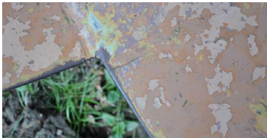
Slika 65. Napuknuće čelične trake na elementu 2 (foto: S. M. Sunara, rujan 2017.)
