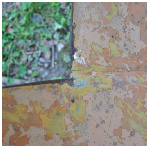
Slika 66. Napuknuće čelične trake na elementu 1 (foto: S. M. Sunara, rujan 2017.)
