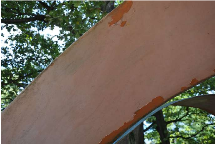
Slika 68. S unutrašnje strane latica, u gornjem dijelu, premazni se slojevi ljušte duž rubova čeličnih traka (foto: S. M. Sunara, rujan 2017.)
