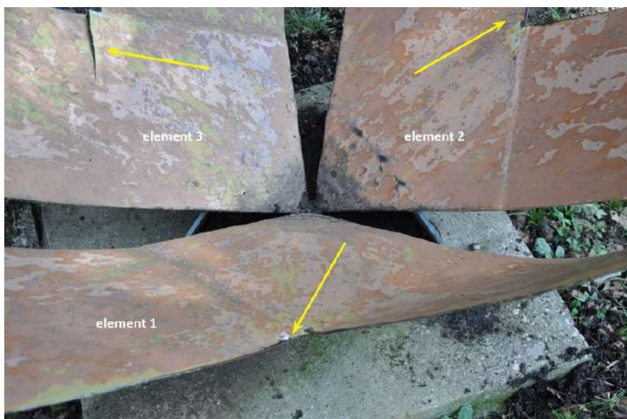
Slika 63. Napuknuća čeličnih traka koje tvore latice (foto: S. M. Sunara, rujan 2017.)
