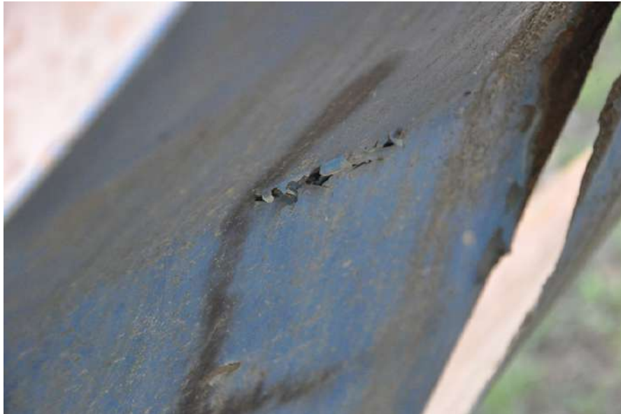
Slika 70. Oštećenje premaznih slojeva na mjestu deformacije čelične trake – vanjska strana elementa 2 (foto: S. M. Sunara, rujan 2017.)
