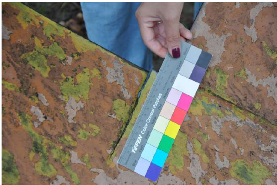
Slika 64. Napuknuće čelične trake na elementu 3 (foto: S. M. Sunara, rujan 2017.)
