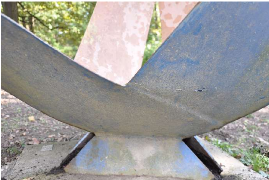
Slika 15. Pobrušeni varni spojevi u donjem dijelu latice i neobrađeni var na spoju metalne baze s laticom (foto: S. M. Sunara, rujan 2017.)
